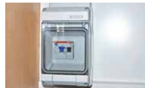
Coffret de distribution avec FI et fusible (16 ampères)
